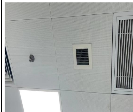
设置气体导出口通活性炭处理措施
